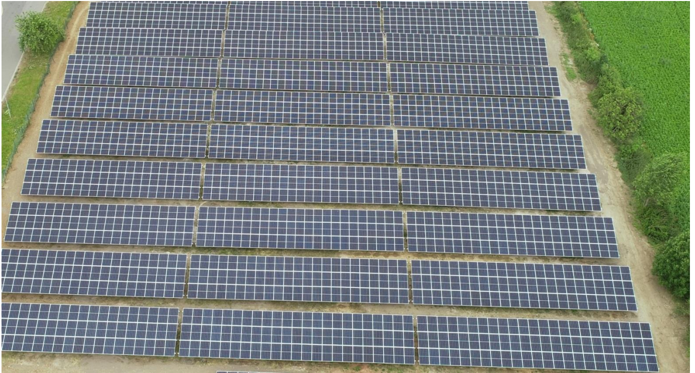
740 kWp Solarpark Thüringen 27
